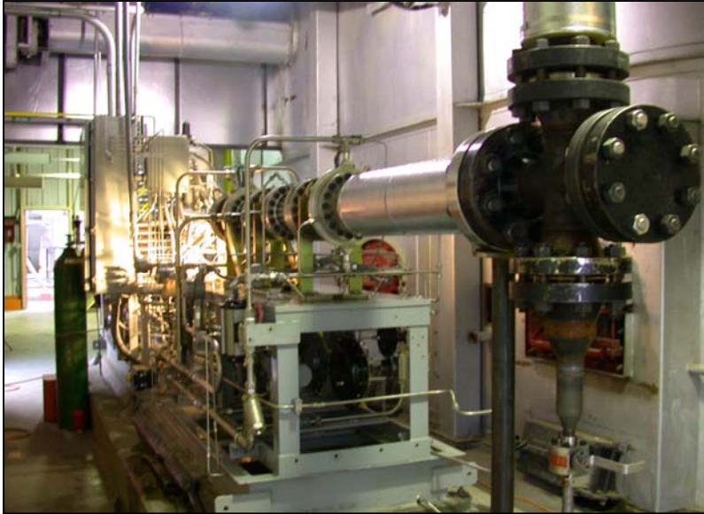
CES 20 MW t Gas Generator
